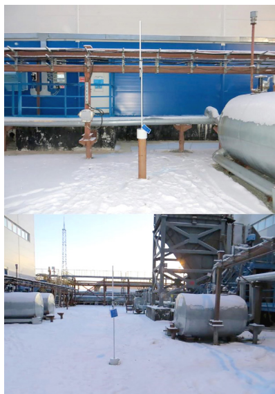
Рис. 2 Дожимная компрессорная станция
