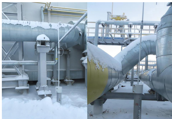
Рис. 1 Дожимная компрессорная станция
